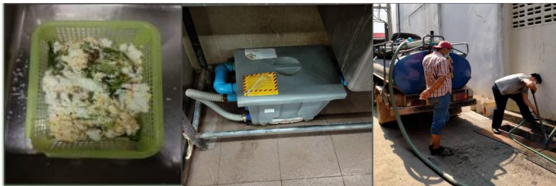
ภาพที่ ๕๕ การติดตั้งตะแกรง ดักดักไขมัน การดูดไขมัน ของสถานประกอบการที่มีการทำอาหาร
